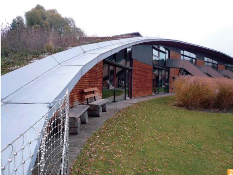
屋上緑化を採用した校舎屋上。漏水センサーを搭載することで防水施工のオーバーバックを防ぐ
