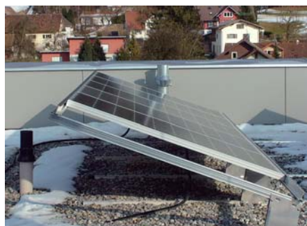
校舎屋根に設置した太陽電池。最大出力26kWで全校舎の暖房、換気、給湯に必要な電力をまかなう
