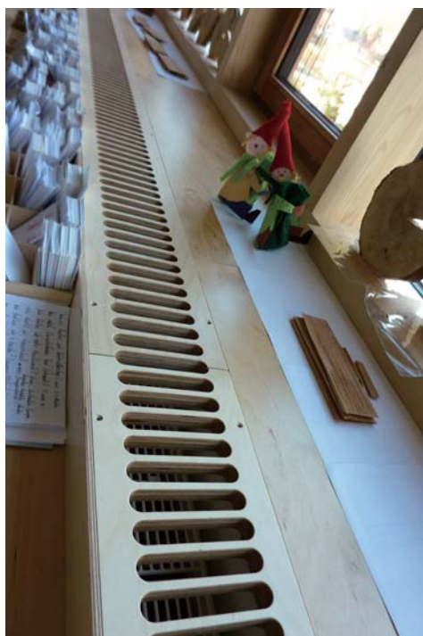
体育館外壁の太陽熱温水パネルでつくった温水が各部屋のパネルヒーター暖房に送られる
