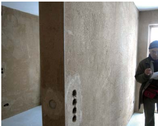
レンガ造壁表面に塗られた土壁。この中に温水パイプを回して壁暖房とする
