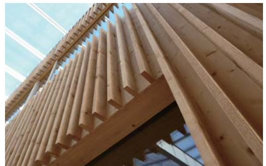
【12】外壁に使用した白モミの無垢材。1棟の使用量は約280㎡に達する
